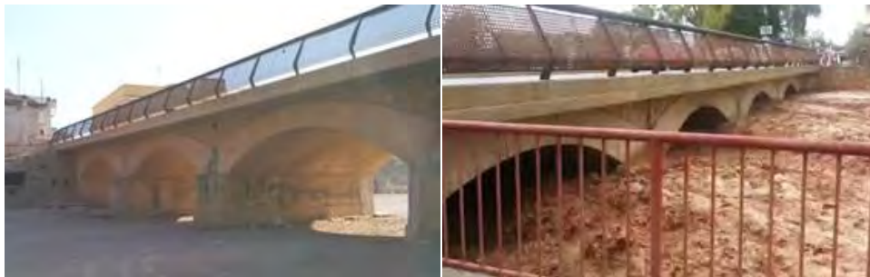
Figura 1. Puente de San Francisco situado en Fuente Álamo (Murcia) en situación habitual y durante la avenida del 28/09/2012
