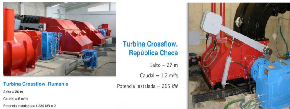
Figura 30: Ejemplos de instalación de turbinas de flujo cruzado en Europa, fuente CINK HIDRO ENERGY.
