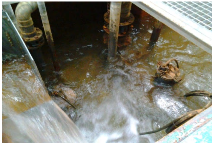
Figura 28: Cántara de bombeo.
