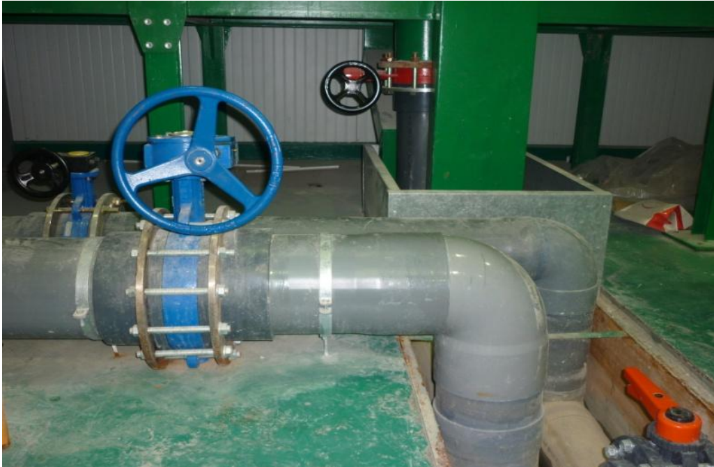
Figura 3.8. Válvula de mariposa en las tuberías de impulsión.
