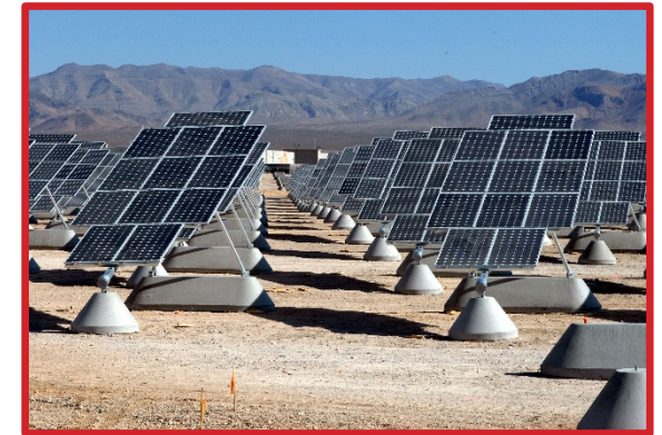
Instalaciones de generación
